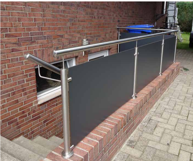
Fotos zeigen Fassaden-Schichtstoffplatten!
